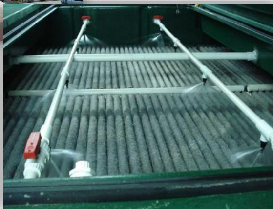
Εικόνα 4-κάτω. Το σύστημα επεξεργασίας λυμάτων AdvanTex σε λειτουργία.
