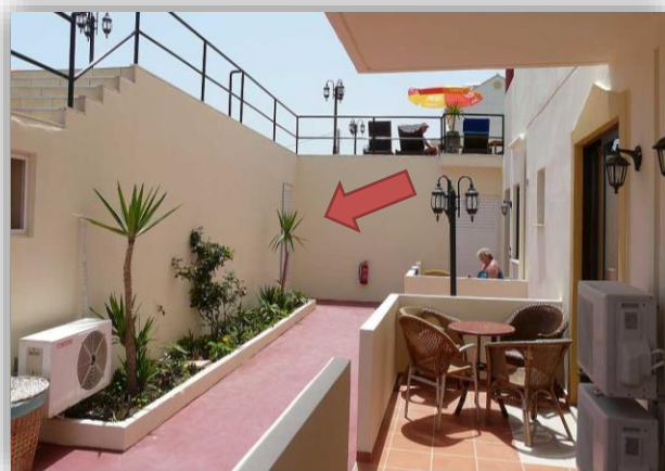
Εικόνα 2. Η θέση του Βιολογικού δίπλα ακριβώς σε δωμάτια.
